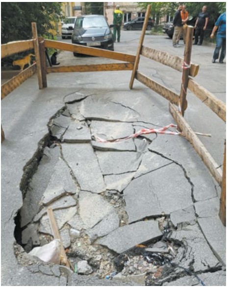
Несущие конструкции подвесных дворов не выдерживают нагрузок: некоторым балкам и опорам — больше 100 лет.
