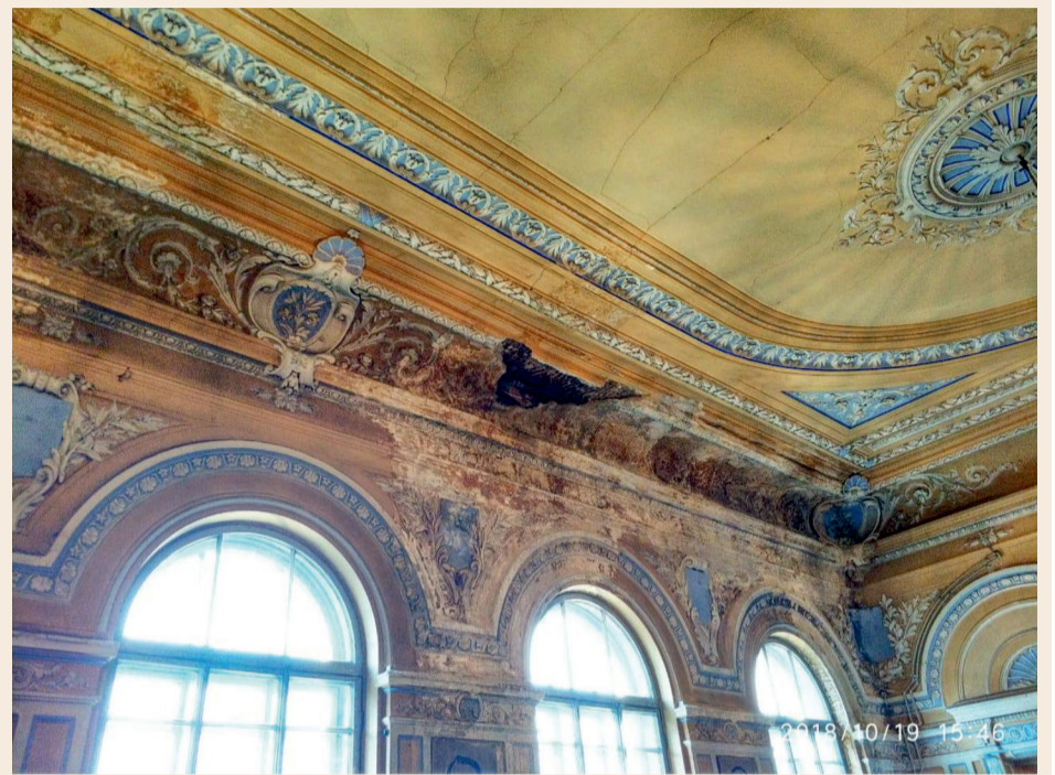
До реставрации состояние зала было аварийным
